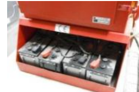
Batteries pour un groupe
