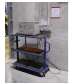
Poste de charge isolé
